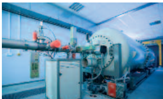
Accélérateur AIFIRA du Centre d'Etudes Nucléaires de Bordeaux Gradignan
